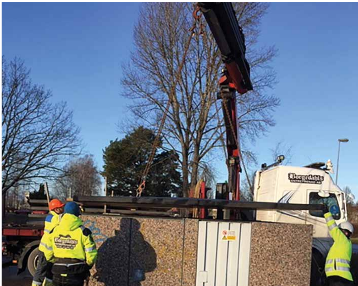
Under 2019 har taken på ett antal transformatorstationer bytts ut. På bilden är det taket på transformatorstationen på Södra Långgatan som byts ut. Foto: Tibro Elnät AB
