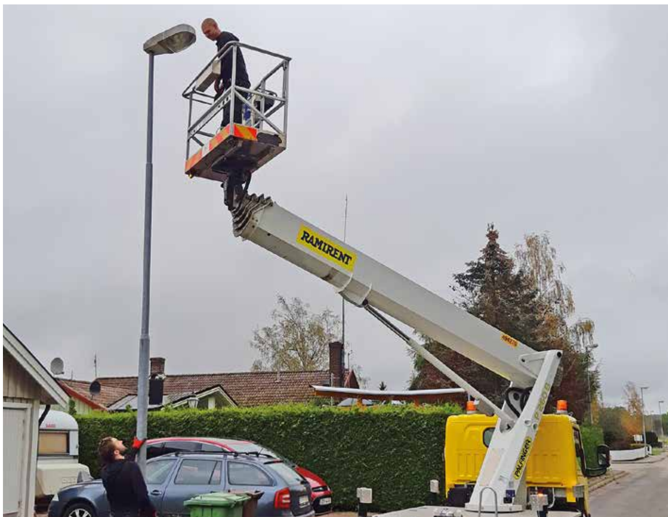
Tibro kommun har under flera år satsat på att modernisera gatubelysningsnätet i syfte att minska energiförbrukningen. Under 2019 installerades 570 nya LED-lampor. Foto: Jacob Ingelsson
