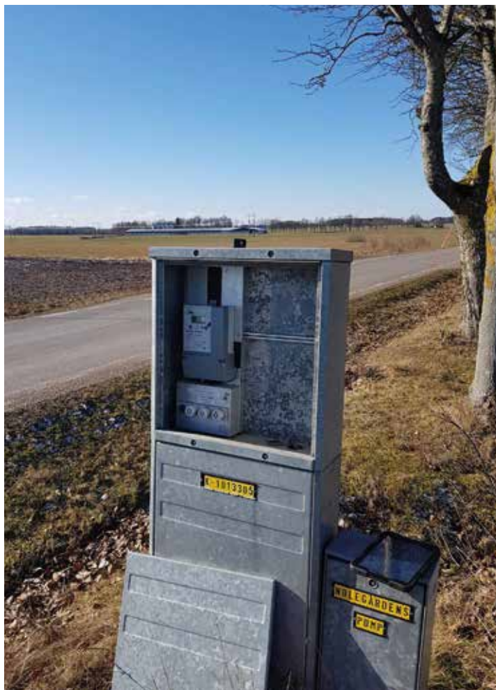
Hösten 2018 inledde Tibro Elnät AB ett femårigt projekt med att byta ut befintliga elmätare mot en ny modell, som svarar upp mot nya myndighetskrav. Foto: Tibro Elnät AB
