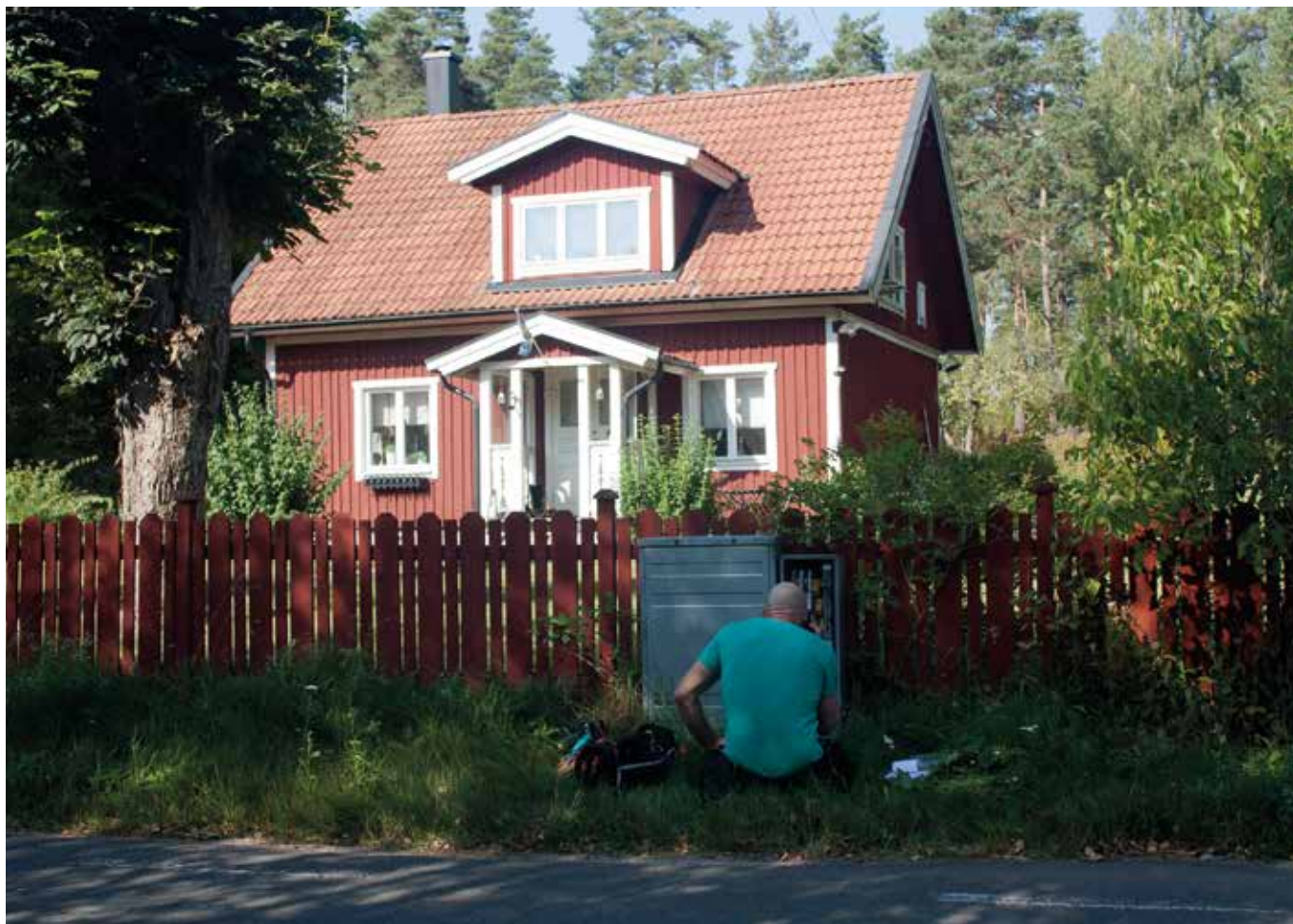
Tibro Elnät AB arbetar fortlöpande med underhåll och utbyggnad av elnätet med målet att anläggningarna ska ha en hög standard med få avbrott. Foto: Tibro Elnät AB
