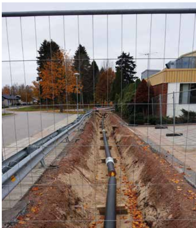
Ett läckage på fjärrvärmenätet gjorde att anslutningarna vid kommunens sporthallar byttes ut under hösten. Foto: Dan Carlsson
