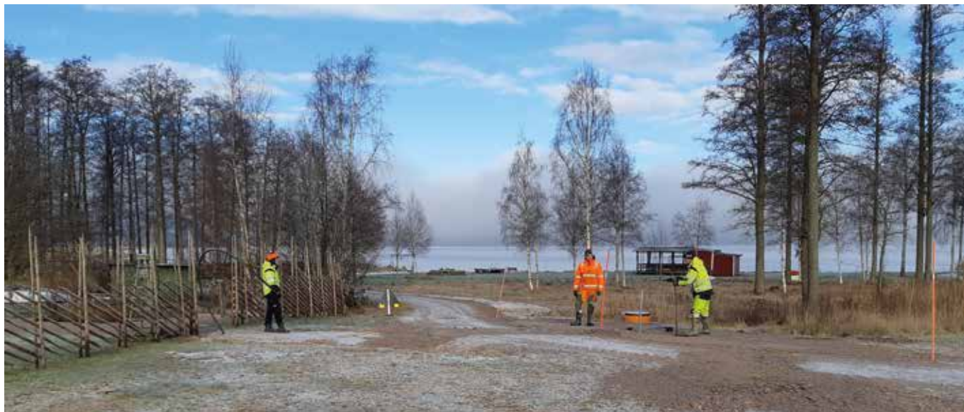
Under hösten 2020 påbörjades arbetet med att lägga ner en ny vattenledning mellan Bråbacka och Kylvånäs, en sträcka på cirka 3 300 meter. Foto: Jacob Ingelsson
