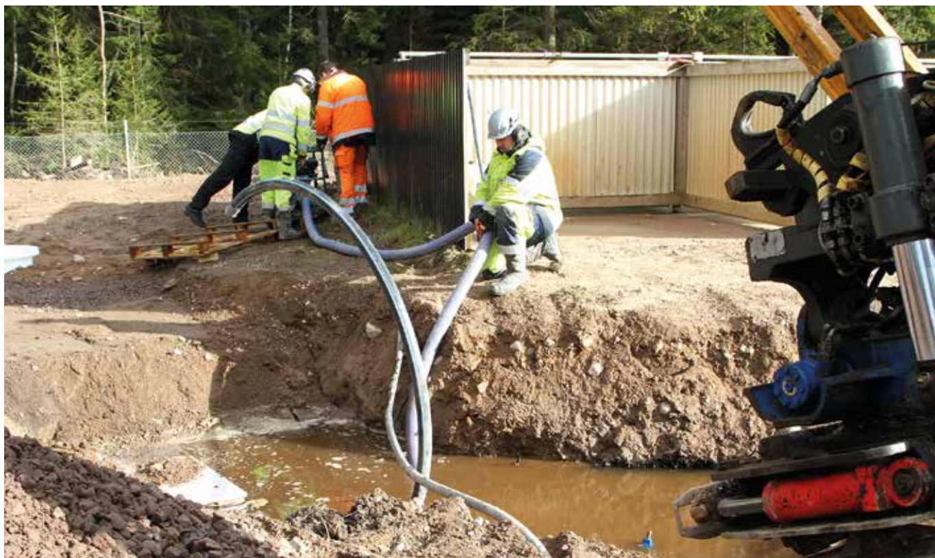
2015 anslöts Tibro Motorstadion till det kommunala vatten- och avloppsledningsnätet. Under 2016 planeras delar av ledningsnätet i Fagersanna bytas ut och arbetet med att ansluta sommarstugeområdet Sörosets vatten- och avloppsledningsnät till det kommunala nätet fortsätter. Foto: Christina Froh
